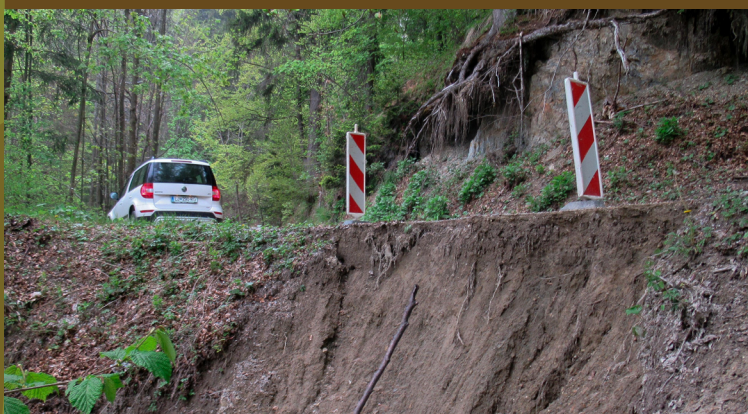
Plaz, ki je porušil cesto.
