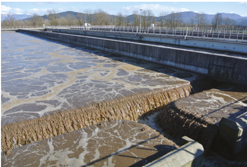
Slika 83: Del sistema sekundarnega čiščenja na Centralni čistilni napravi Ljubljana.
